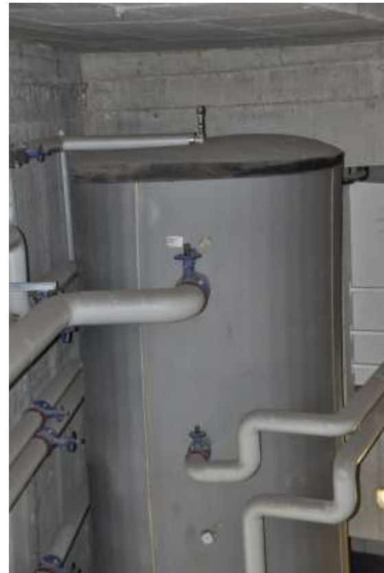
15.000 l Boiler im Heizraum
